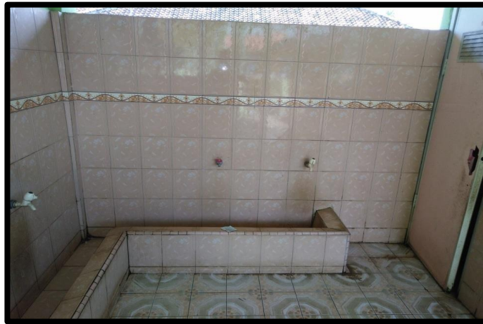
Gambar 9. Tempat Toilet dan Wudhu Sebelum Renovasi (Masjid Khoirul Huda).
