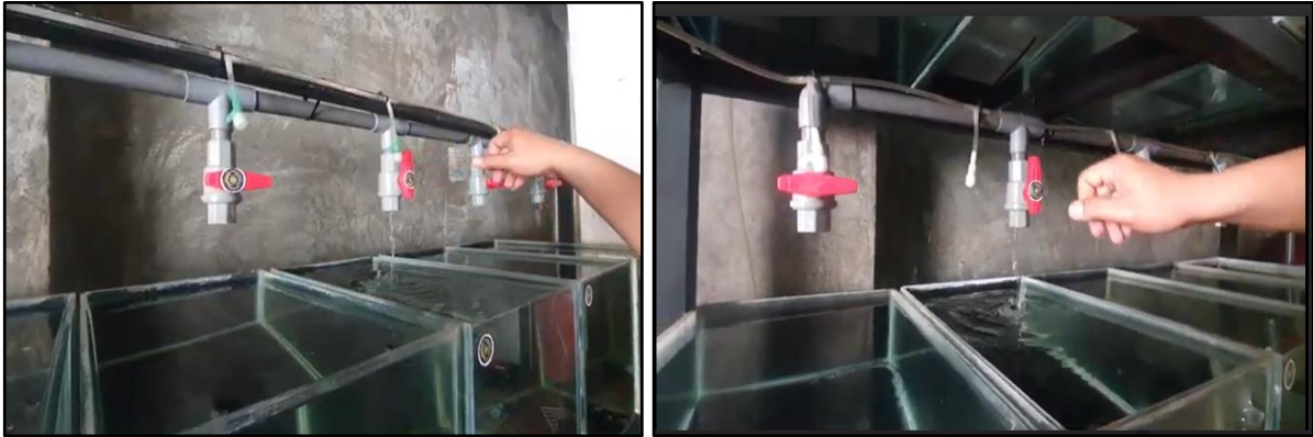
Gambar 6. Aliran Air dari Pipa Penyaringan kedalam Rak Susun
