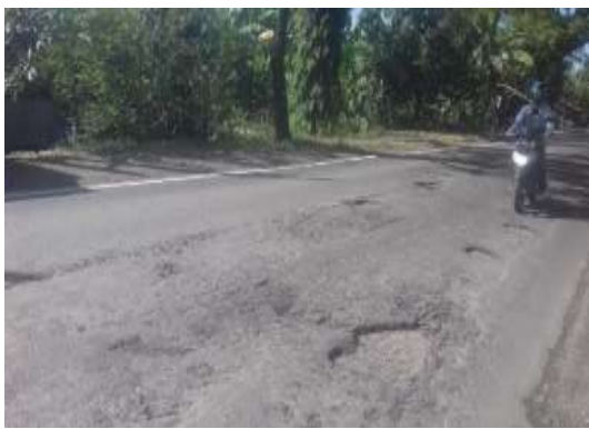
Gambar 1. Dokumentasi Survey Lokasi Kerusakan Jalan. (Sumber: Dokumentasi Penelitian, 2023)
