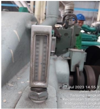
Gambar 3. Thermometer turbin yang berdekatan dengan pipa output line steam menuju back pressure vessel (BPV)
