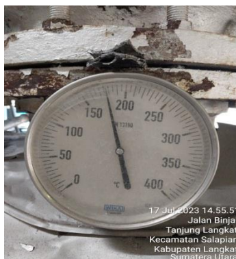
Gambar 5. Thermometer back pressure vessel (BPV) yang berdekatan dengan pangkal pipa input line steam back pressure vessel (BPV) dari turbin
