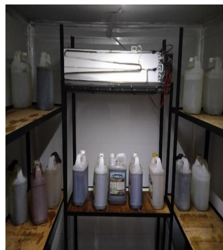
Gambar 13. Penempatan Evaporator dan Defrost
