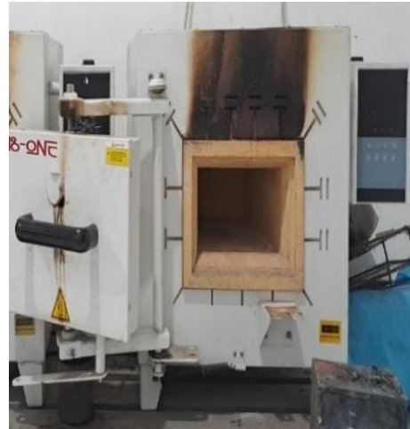
Gambar 2. Tungku Pemanas ( Furnace )
