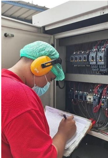
Gambar 4. Pemeriksaan Utility (Chiller)
