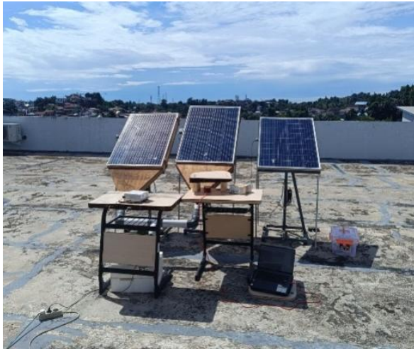
Gambar 2. Pengujian panel surya di atap gedung F Fakultas Sainteks UMKT
