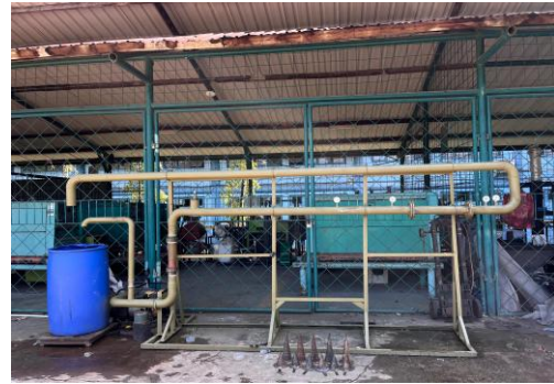
Gambar 4 Perangkat Uji ( Sistem Perpipaan)
