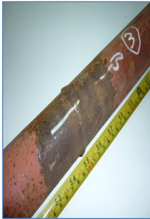
Gambar 3. Hasil proses las pada tube Economizer yang kena korosi dan incomplete penetration
